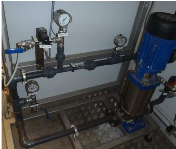
Abbildung 18: Ozoneinspeisung in Bypassleitung, Pumpe und Injektor.
