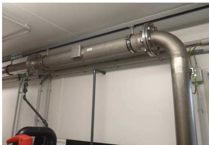
Abbildung 13: Statischer Mischer und Einspeisung von \text{H}_2\text{O}_2 in die Hauptleitung
