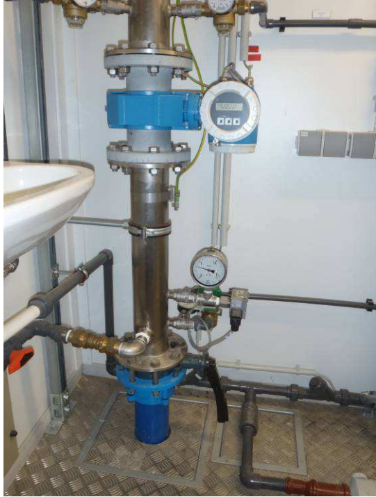
Abbildung 10: Durchflussmesser im Zulauf der Anlage
