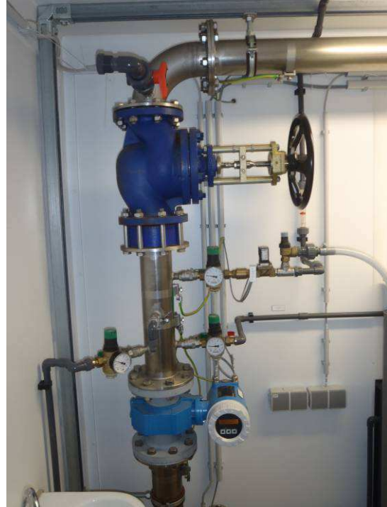
Abbildung 11: Hauptleitung mit Schieber, Druckminderung und Bypassleitungen für Kühlung, Ozon- und \text{H}_2\text{O}_2 -Einmischung
