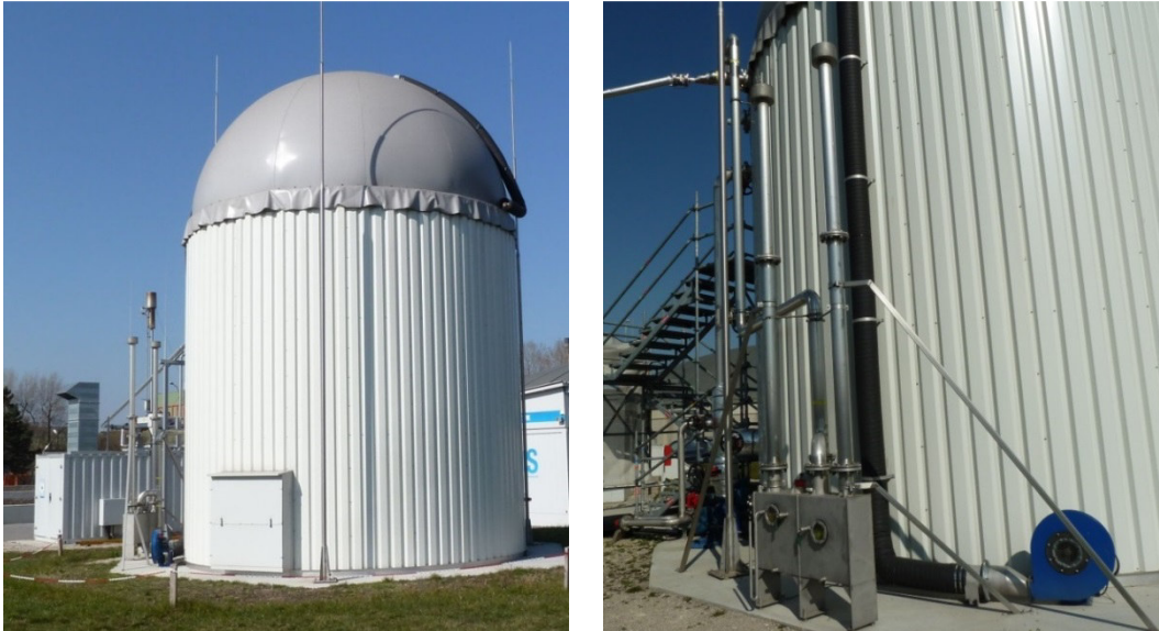
Abbildung 56: Faulbehälter; links: rückwärtige Ansicht mit Abluftschlauch der Stützluft; rechts: Über-/Unterdrucksicherung und Stützluftgebläse (Aufnahmedatum: 11.03.2014)
