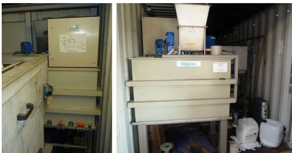
Abbildung 51: Polymeraufbereitungsanlage der MÜSE; links: Blick vom Seihband zur Container-Doppeltüre; rechts: Blick von außen in den Container
