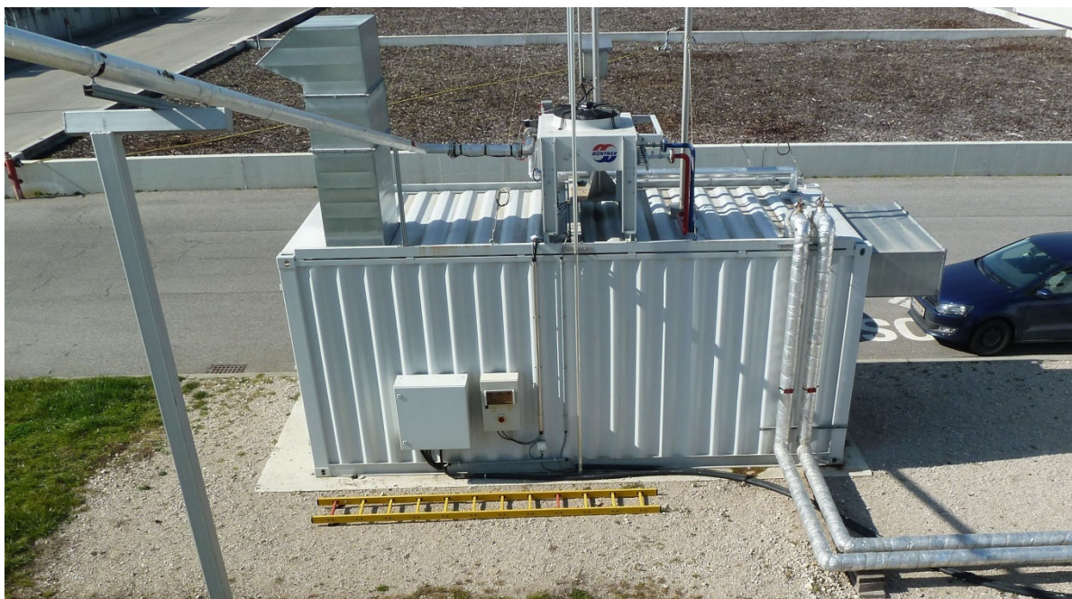
Abbildung 57: Blockheizkraftwerk (BHKW) der Versuchsanlage; Blick vom Faulbehälter (Aufnahmedatum: 11.03.2014)
