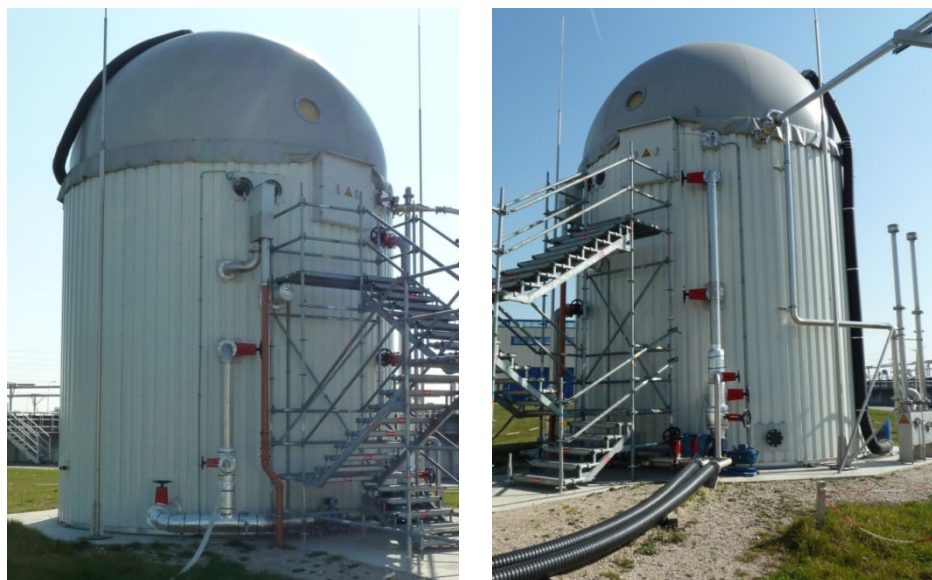
Abbildung 55: Faulbehälter; links: Entnahme und Überlaufkasten; rechts: Zulauf, Gasleitung (Aufnahmedatum: 11.03.2014)
