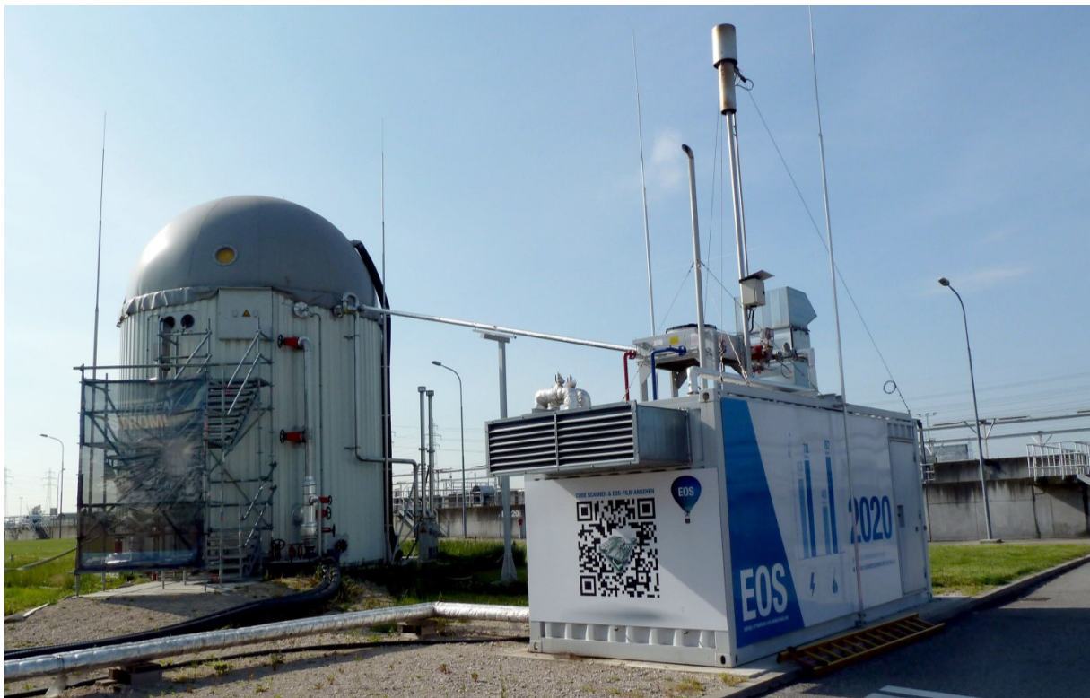
Abbildung 49: Versuchsanlage, Außenansicht: Faulbehälter und BHKW (Aufnahmedatum: 17.04.2013)
