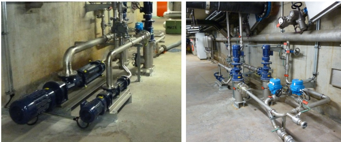
Abbildung 44: Schlammumpen im Keller beim Mischbauwerk; links: Pumpen; rechts: Verrohrung (Aufnahmedatum: 11.03.2014)
