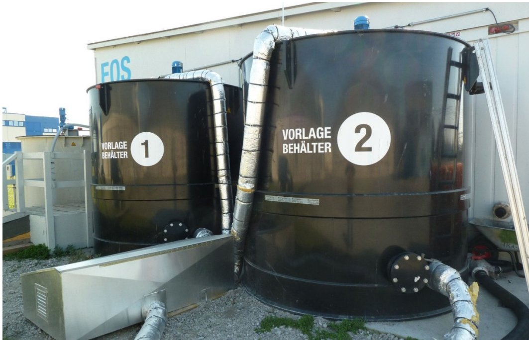
Abbildung 45: Vorlagebehälter 1 und 2 (Speicherbehälter für Rohschlamm) (Aufnahmedatum: 11.03.2014)
