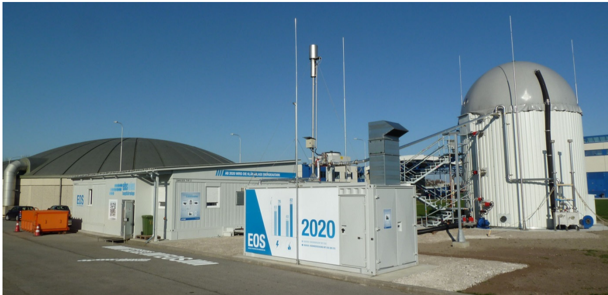
Abbildung 48: Versuchsanlage, Außenansicht (Aufnahmedatum: 17.04.2013)
