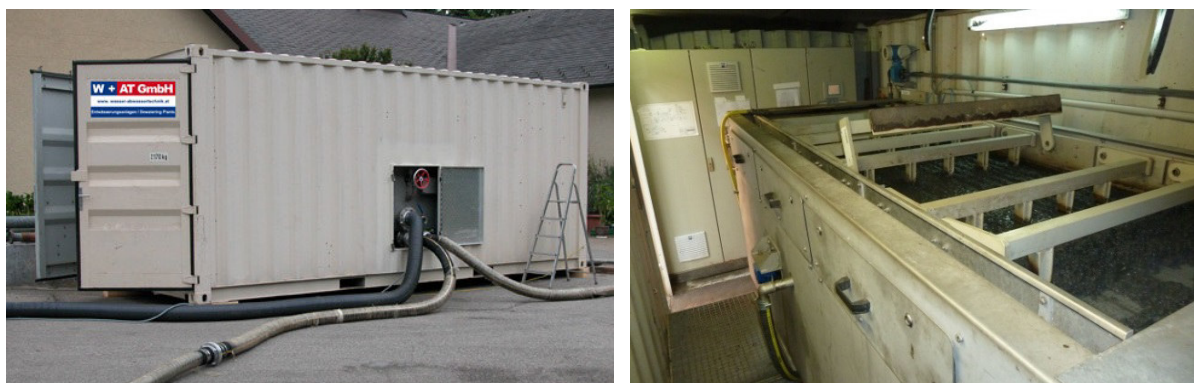
Abbildung 50: MÜSE (Maschinelle Überschussschlammverdickung); links: Außenansicht des Containers; rechts: Innenansicht Seihband und Schaltschrank)
